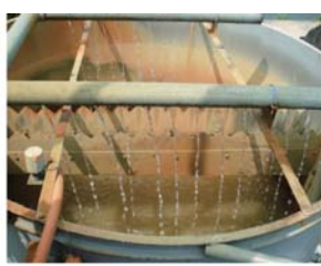
上面から見た生物濾過池
