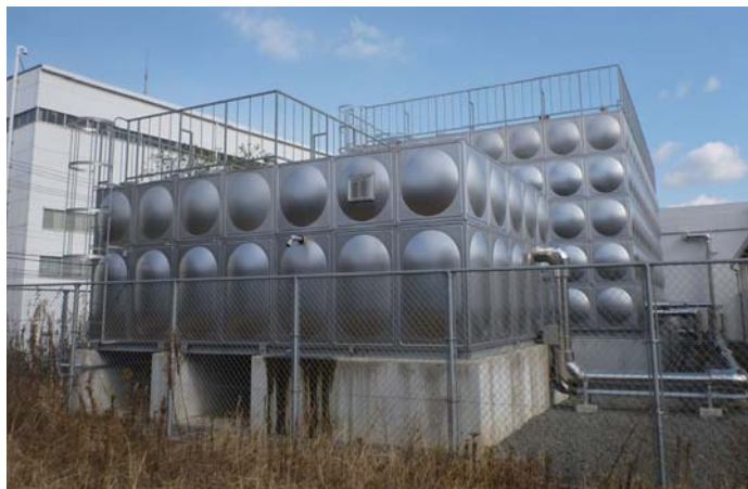
写真3：新設された2基(50トン、500トン)の受水槽
