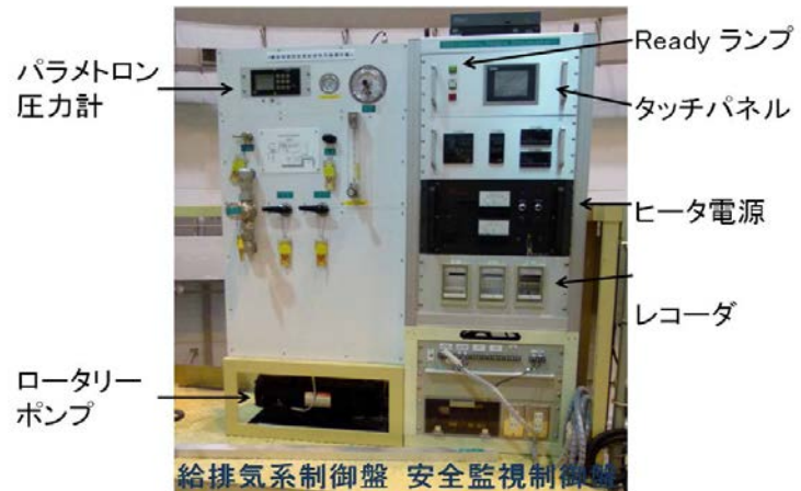
図 2. 給排気系制御盤と安全監視制御盤
