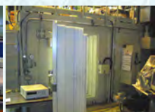
TNRFの撮影室の遮蔽扉
