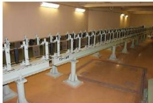
中性子導管 (目視では被害は認められていない)
