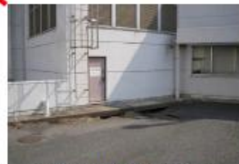
実験利用棟周辺の地盤沈下
