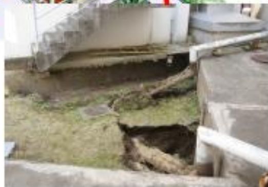
燃料管理施設周辺の地盤沈下
