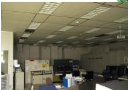
室内天井内装の破損
