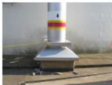
地盤沈下による排気ダクト への応力負荷状況
