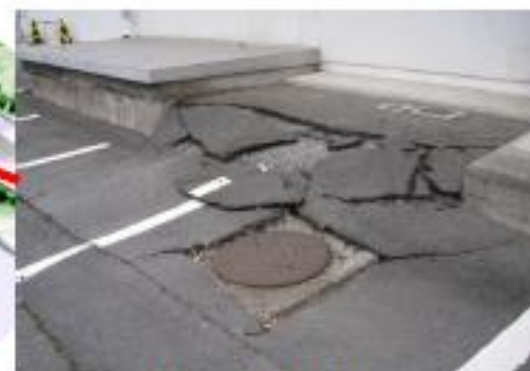
実験利用棟周辺の地盤沈下
