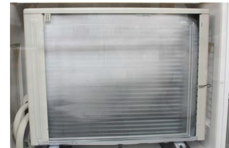
ヒートポンプ(室外機)
