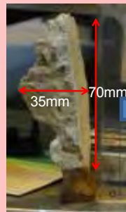
コンクリート片
