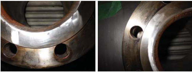
覗き窓の腐食：熱交換器No.3
