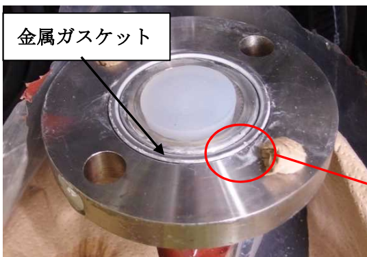
写真3 漏洩箇所のステンレス製フランジ
