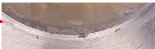
写真6 腐食部の拡大
