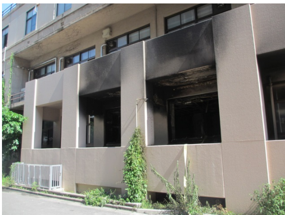
実際の火災現場
