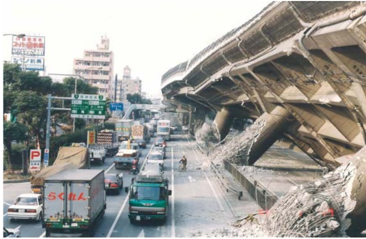
1995年阪神淡路大震災(阪神高速の倒壊)
