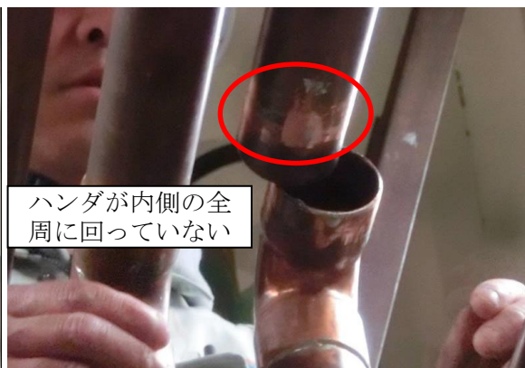
図4 ハンダ溶接の不備
