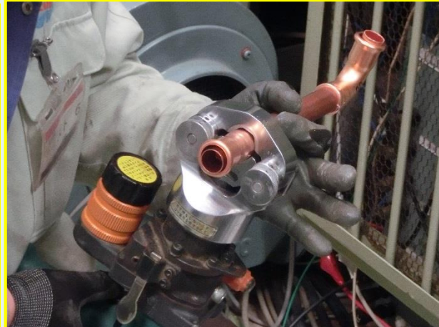
圧着接続配管
