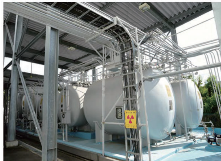
廃棄物処理設備タンクヤード
