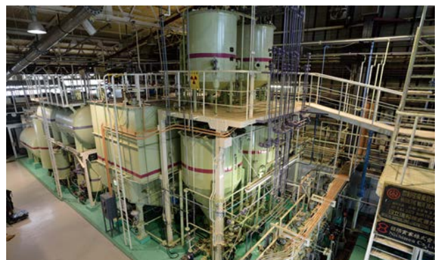
液体廃棄物処理装置
