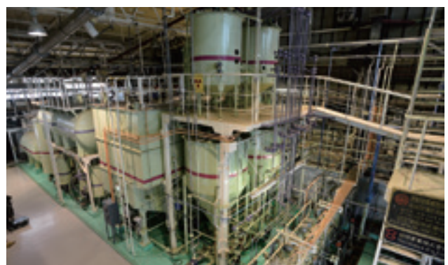
液体廃棄物処理装置
