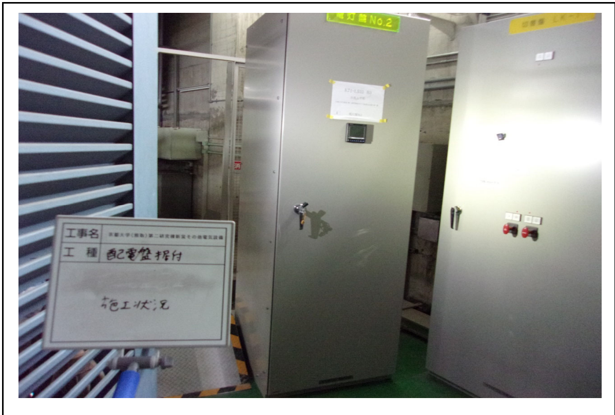
写真説明：臨界集合体実験棟 電灯盤No. 2設置状況 令和 4 年 10月 8日 撮影
