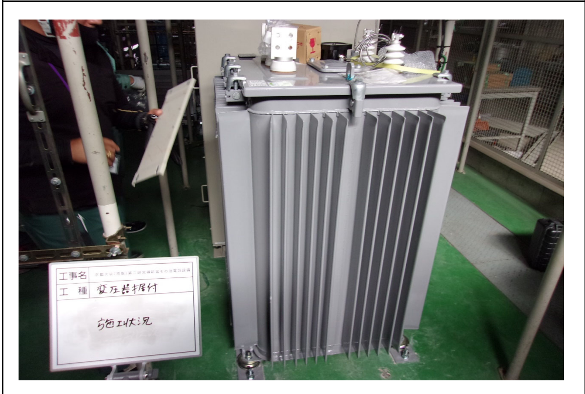
写真説明：臨界集合体実験棟 変圧器 (1φ 3001VA) 設置状況 令和 4 年 10月 8日 撮影
