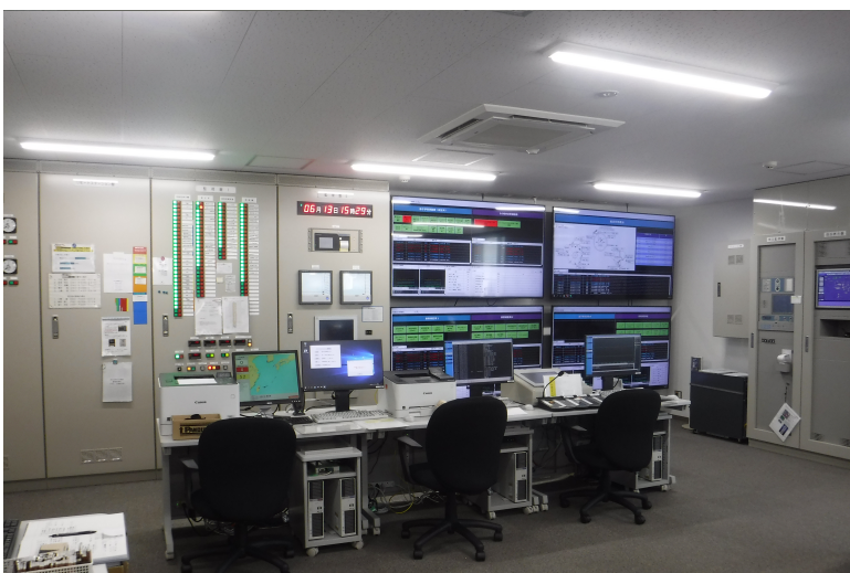
005 1階中央管理室・RI管理室
