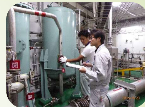
研究炉冷却系統の点検
